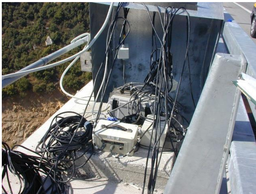
Φωτογραφία Δ.6 Κεντρική μονάδα κινητού συστήματος επιταχυνσιόμετρων στο κεντρικό άνοιγμα της 2 ης χαραδρογέφυρας Καβάλας.
