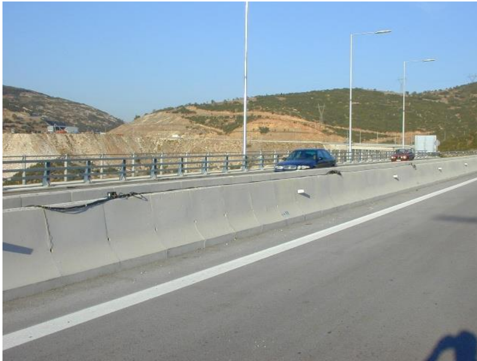
Φωτογραφία Δ.5 Τοποθέτηση αισθητήρων στο κεντρικό στηθαίο New Jersey στο κεντρικό άνοιγμα της 2 ης χαραδρογέφυρας Καβάλας.
