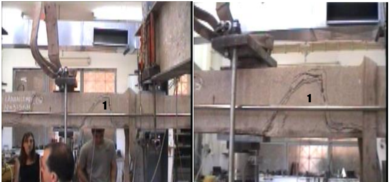
Σχήμα Α9 Μορφή αστοχίας δοκιμίου Α2-Δ. (Ξαφνική αστοχία στη θέση 1 (θέση σημείου καμπής).)
