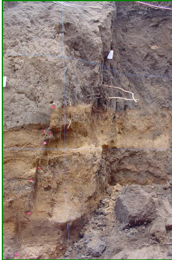
Εικόνα 2-21. Λεπτομέρεια της ρηξιγενούς ζώνης, όπως αυτή είναι ορατή στο ανατολικό τοίχωμα της παλαιοσεισμολογικής τομής GER-4.
