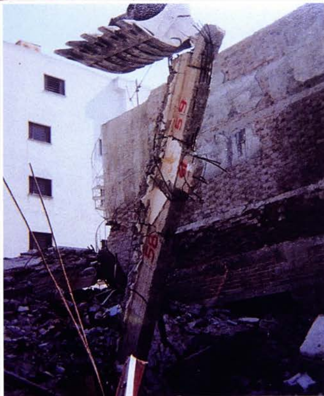
Φωτ. 9-10 Άρση τμήματος πλάκας (Φωτ. 9) και δοκού (Φωτ. 10) από εκκα- φέα τσάπα. Έκκεντρη πρόσδεση ώστε ο κύριος οπλισμός του δομικού στοιχείου να πάρει κατα- κόρυφη διεύθυνση προς απο- φυγή τυχόν αναδίπλωσης του. (Ερευνα Αιτίων Κατάρρευσης, Λουτράκι 1981)
