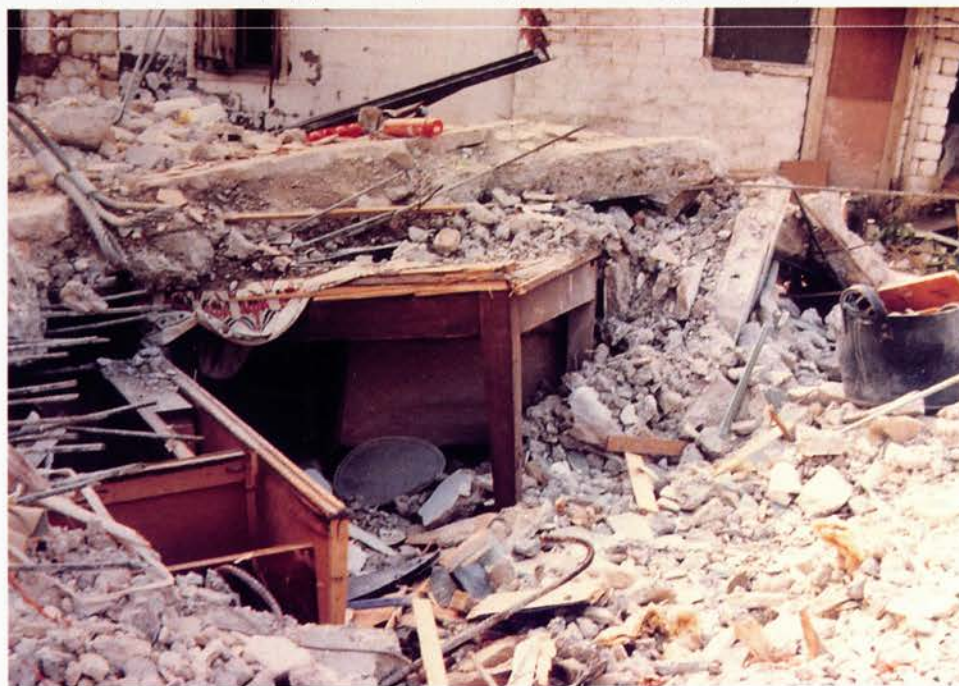
Φωτο 2: Το τραπέζι εκτός από κάποιες φθορές στο πάνω του μέρος, φαίνεται να έχει διατηρήσει την γεωμετρία του και να είναι κενό από δομικά υλικά στον χώρο που καλύπτει. Ιδανικός χώρος κάλυψης κατά την διάρκεια του σεισμού. (Καλαμάτα 1986)
