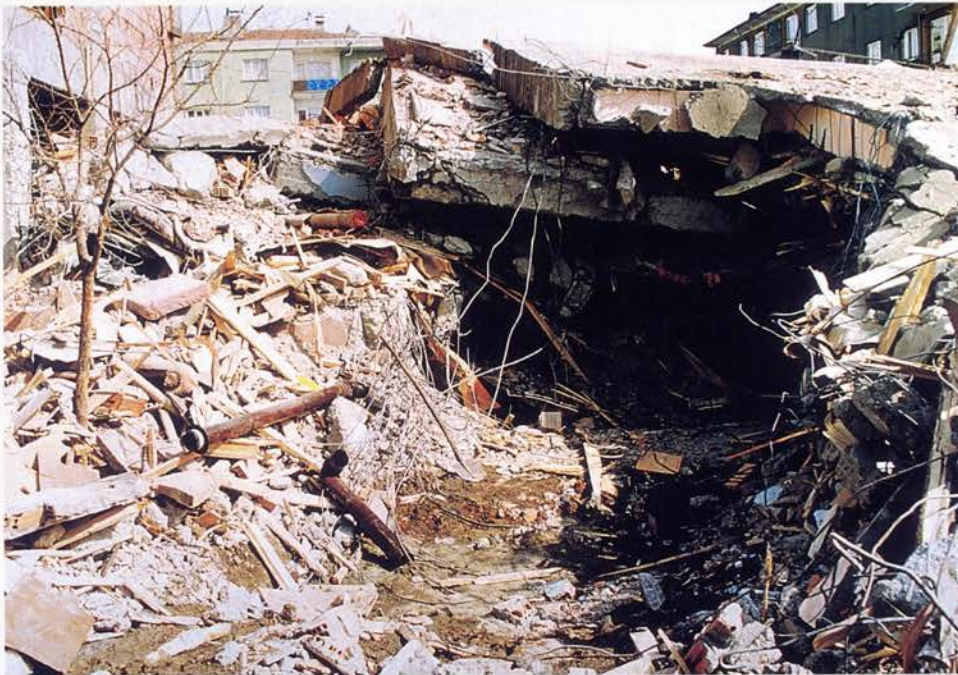
Φωτ. 15: Δημιουργία ευρέως μετώπου για διείσδυση στο ερείπιο με την απομάκρυνση μεγάλου τμήματος του κτιρίου στην πρόσοψη. (Μετωπική διείσδυση)
