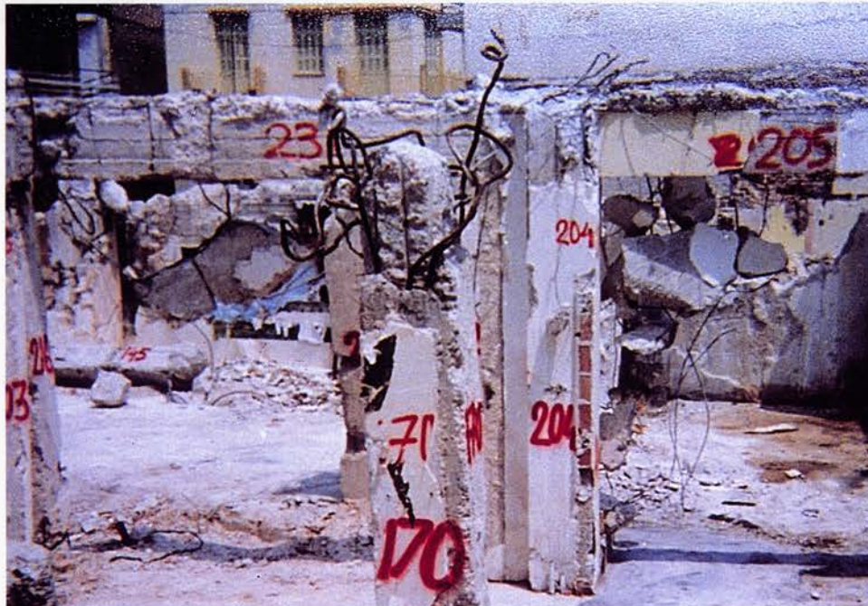
Φωτο 1: Δοκοί και υποστυλώματα του υπογείου. Διατήρηση της γεωμετρίας τους παρά την ολική κατάρρευση πάνω σ' αυτά έξι ορόφων. Εκτός από την ύπαρξη επαρκούς χώρου για επιβίωση, έχει δημιουργηθεί χώρος κατάλληλος και για εκκίνηση κατακόρυφης διείσδυσης ανόδου. (Ερευνα αιτίων κατάρρευσης, Λουτράκι 1981)
