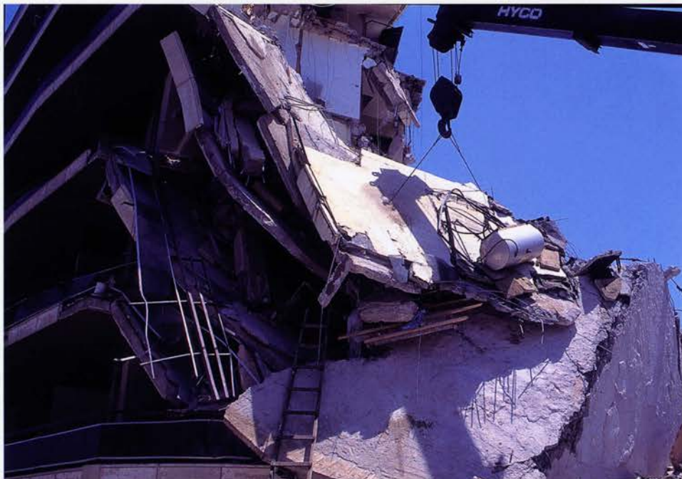
Φωτ. 11: Άρση με γερανό μεγάλου τμήματος πλάκας έντονα κεκλιμένης λόγω της μερικής κατάρρευσης του κτιρίου. Αποκοπή του τμήματος από την υπόλοιπη πλάκα του ορόφου με το κόψιμο του οπλισμού κατά μήκος των γραμμών θραύσης της πλάκας. (Αίγιο 1995)
