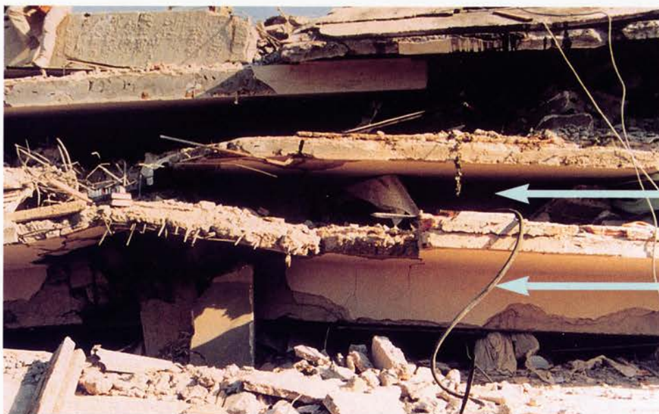
Φωτ. 4: Οι δοκοί των ορόφων στην πρόσοψη του ερειπίου βρίσκονται σε επαφή με τα αντίστοιχα δάπεδα. Ύψος ελεύθερου χώρου ακριβώς πίσω από τις δοκούς 40cm περίπου. Πληροφορίες για ύπαρξη ατόμων λίγο πριν το σεισμό στο χώρο πίσω από τη δοκό Α. Απουσία ενδείξεων ύπαρξης επιζώντων. Έμμεση προσπέλαση στον όπισθεν της δοκού Α χώρο με κοπή τμήματος πλάκας και της δοκού Β που ανήκουν στο δάπεδο του προς έρευνα χώρου (διείσδυση ανόδου). Πλεονεκτήματα της έμμεσης προσπέλασης:
