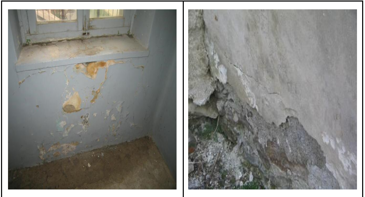
Εικόνα 7. Εκτεταμένη υγρασία, ελλιπής συντήρηση, αποκολλήσεις επιχρισμάτων τοπικού χαρακτήρα σε κατασκευή από φέρουσα τοιχοποιία. Βαθμονόμηση 25%.
