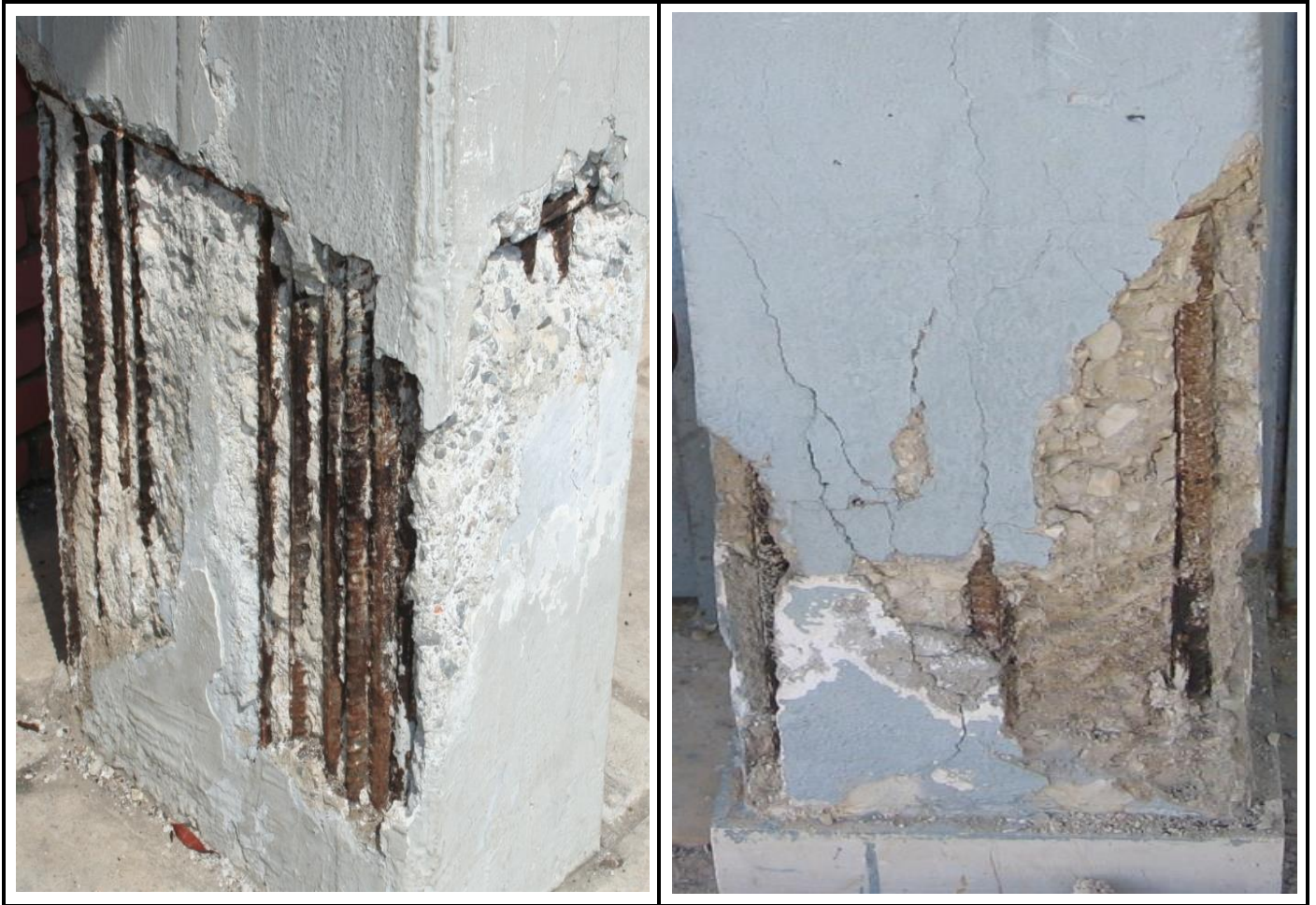
Εικόνα 3. Περιορισμένος βαθμός οξείδωσης οπλισμών. Απουσία συνδετήρων σε κρίσιμη περιοχή. Βαθμονόμηση ανάλογα με την έκταση του προβλήματος και το ποσοστό απομείωσης της διατομής των ράβδων.
