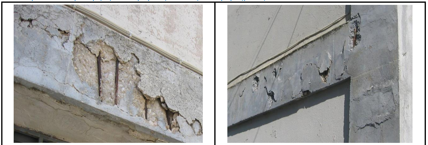
Εικόνα 2. Διάρρηξη – εκτίναξη της επικάλυψης σκυροδέματος. Ένδειξη για την επισταμένη διερεύνηση των κατακορύφων στοιχείων.
