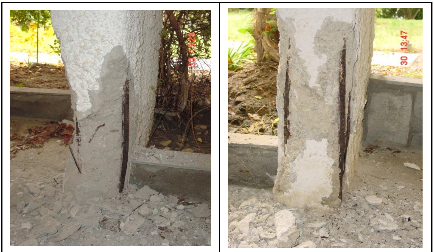
Εικόνα 6. Εύθρυπτο σκυρόδεμα σε οποιοδήποτε κατακόρυφο στοιχείο, σε συνδυασμό με απουσία συνδετήρων και καμπύλωση διαμήκων ράβδων. Βαθμονόμηση 100%.
