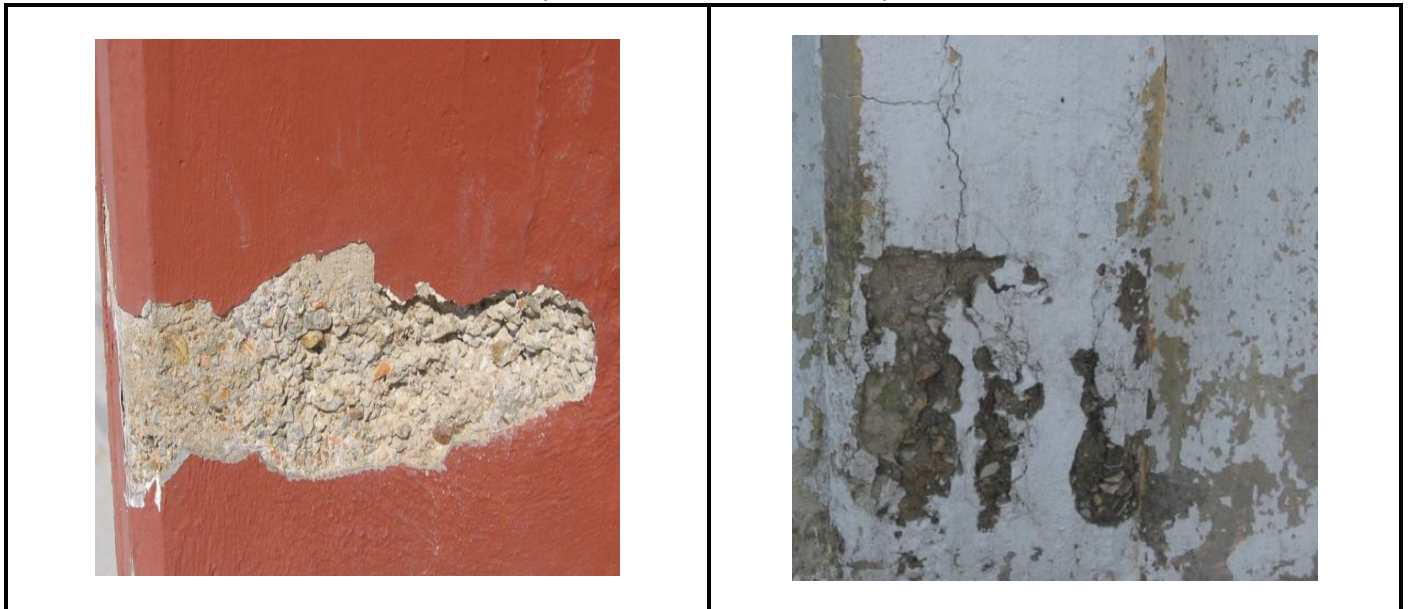
Εικόνα 1. Κακή κατάσταση (ποιότητα) σκυροδέματος. Στην εικόνα αριστερά είναι εμφανής η εύκολη αποκόλληση των αδρανών. Βαθμονόμηση ανάλογα με την έκταση του προβλήματος.
